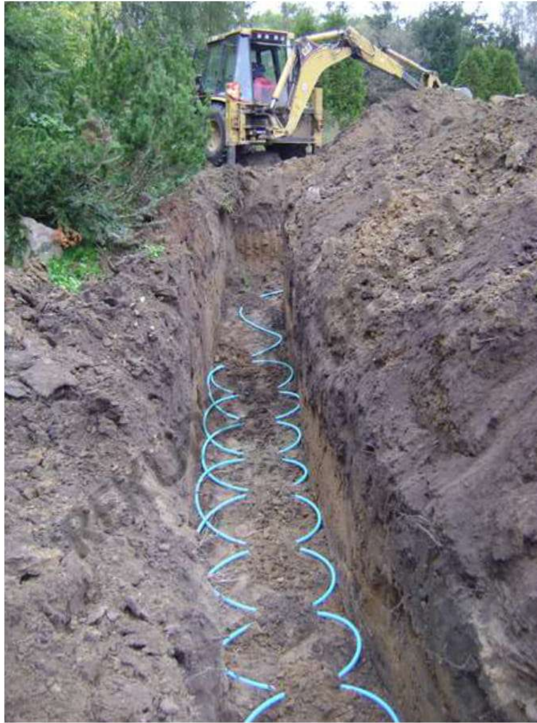
Spiralny sposób ułożenia zewnętrznej instalacji gruntowego glikolowego wymiennika ciepła
